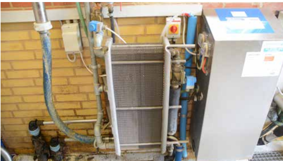
Figur 4. Køling af mælk med dobbelt pladekøler. Køling udføres dels med et kredsløb der forsynes med brøndvand, og dels med et kredsløb der forsynes med koldt vand fra isbank.
