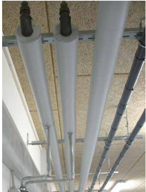
Figur 10. Varmeserier ophængt i gangen i en stald. Rørene er isoleret med mineraluldrørsåle, som er afsluttet med en udvendig plastbeskyttelseskappe (Isogenapack).
