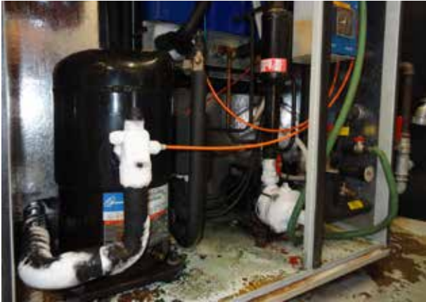
Figur 2. Kompressor i varmepumpeenhed til mælkekøling, med rim pga. lav væske temperatur.
